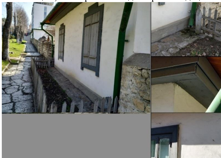
Рисунок 2. Общий вид и дефекты конструктивных элементов дома Чилаева
