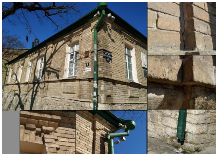
Рисунок 4 . Внешний вид и дефекты конструктивных элементов усадьбы Верзилина
