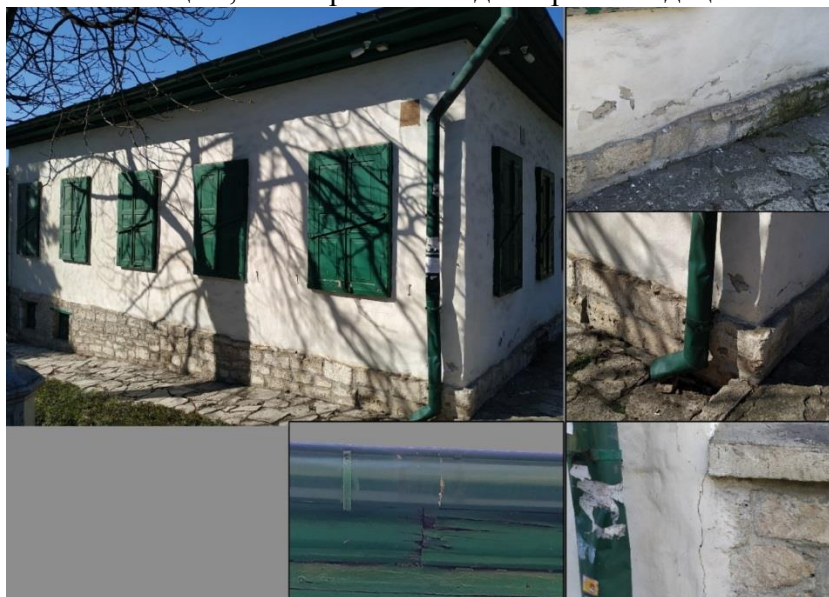
Рисунок 1. Общий вид и дефекты конструктивных элементов дома Уманова
