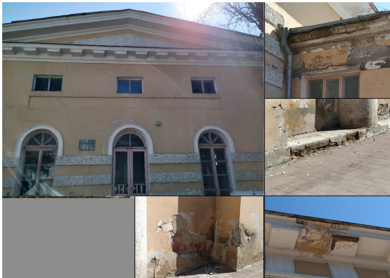
Рисунок 7. Общий вид и дефекты конструктивных элементов здания Лермонтовских ванн
