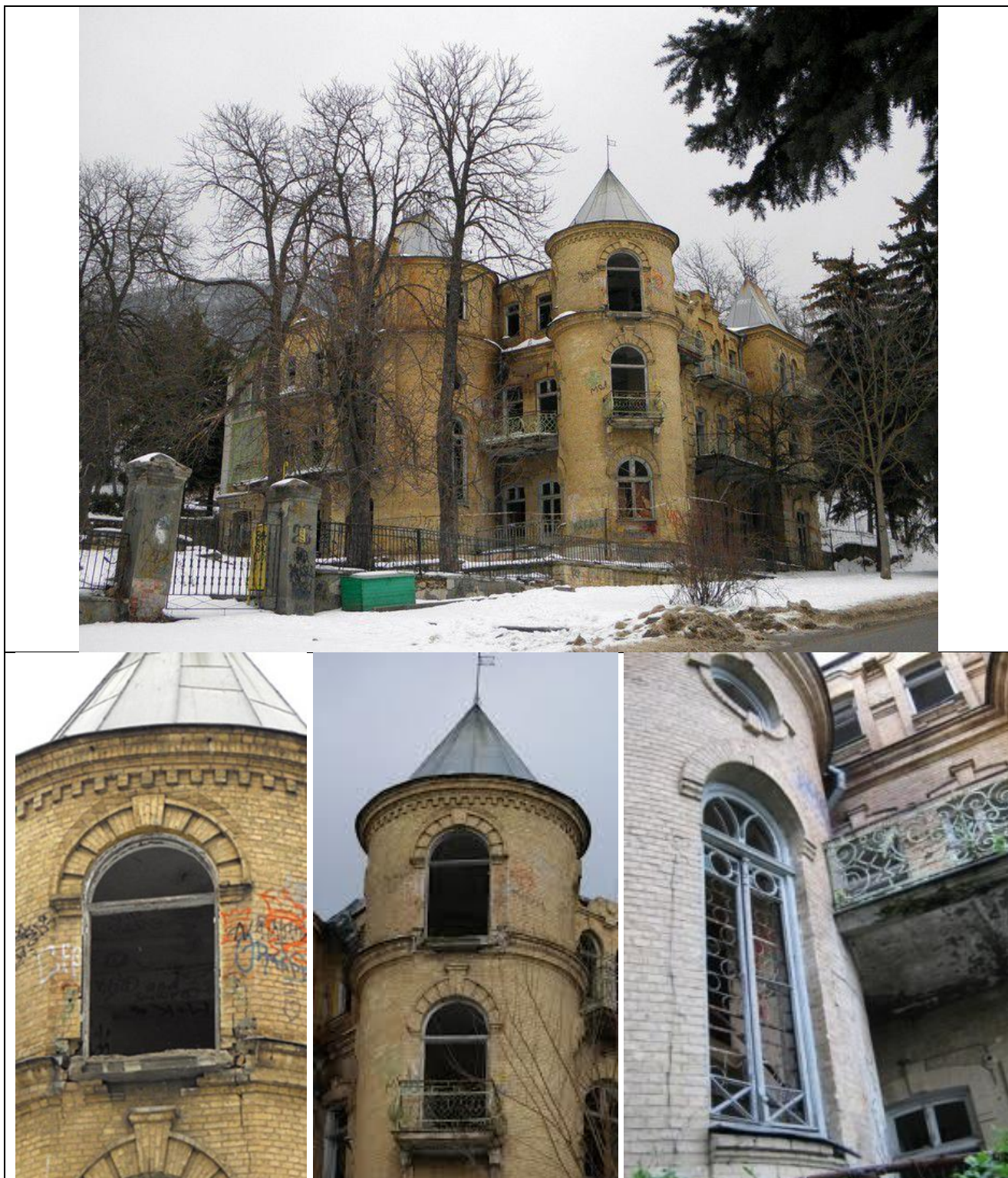
Рисунок 2. Внешний вид особняка Эльзы в настоящее время с зафиксированными дефектами
