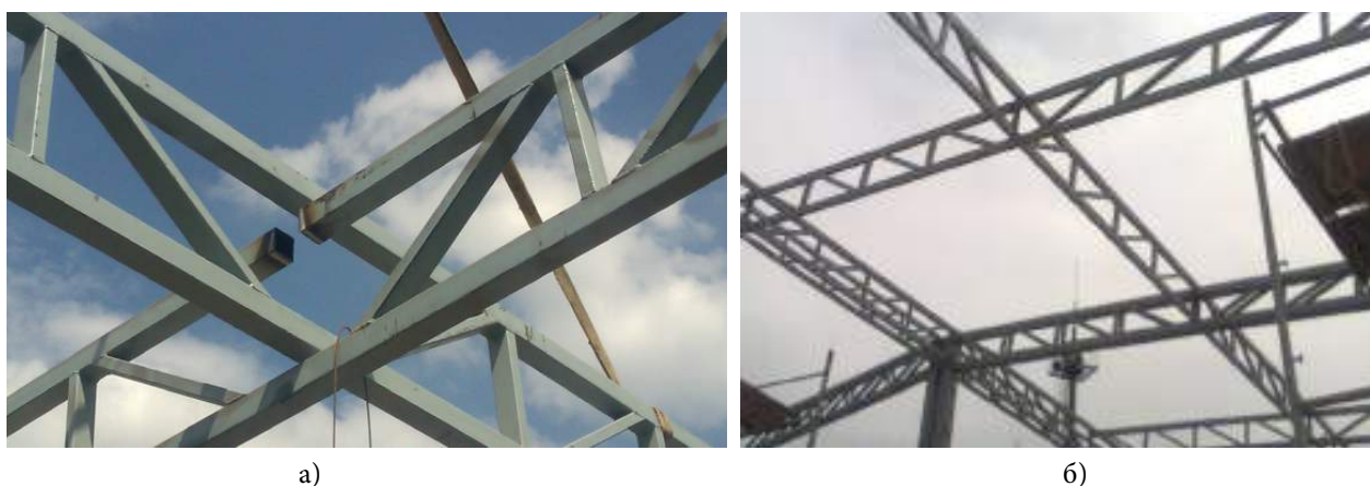
Рис. 3. Снимки монтажного окна узла пересечения (а) и модулей покрытия типа «Пятигорск-2» размерами в плане 6 × 6 м (б)
