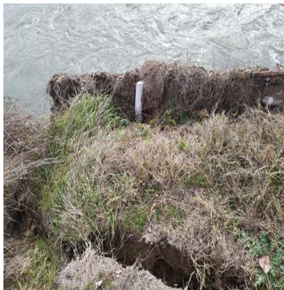
Рисунок 7 – Береговое укрепление, разрушенное в результате размыва берега р. Малка Figure 7 – Coastal fortification destroyed as a result of erosion of the Malka River bank
