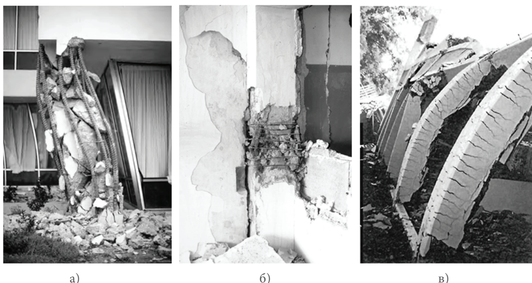
Рис. 1. Повреждения колонн каркасных зданий во время землетрясений:
