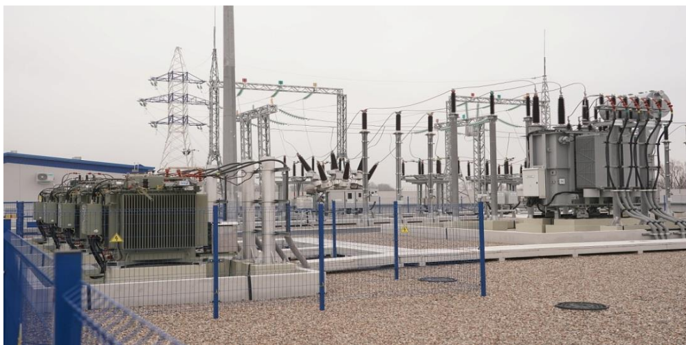
Рисунок 2 - Действующая цифровая подстанция (Калининград)
