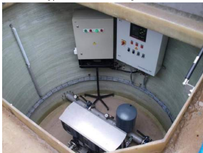
Рис. 5. Подземная насосная станция
