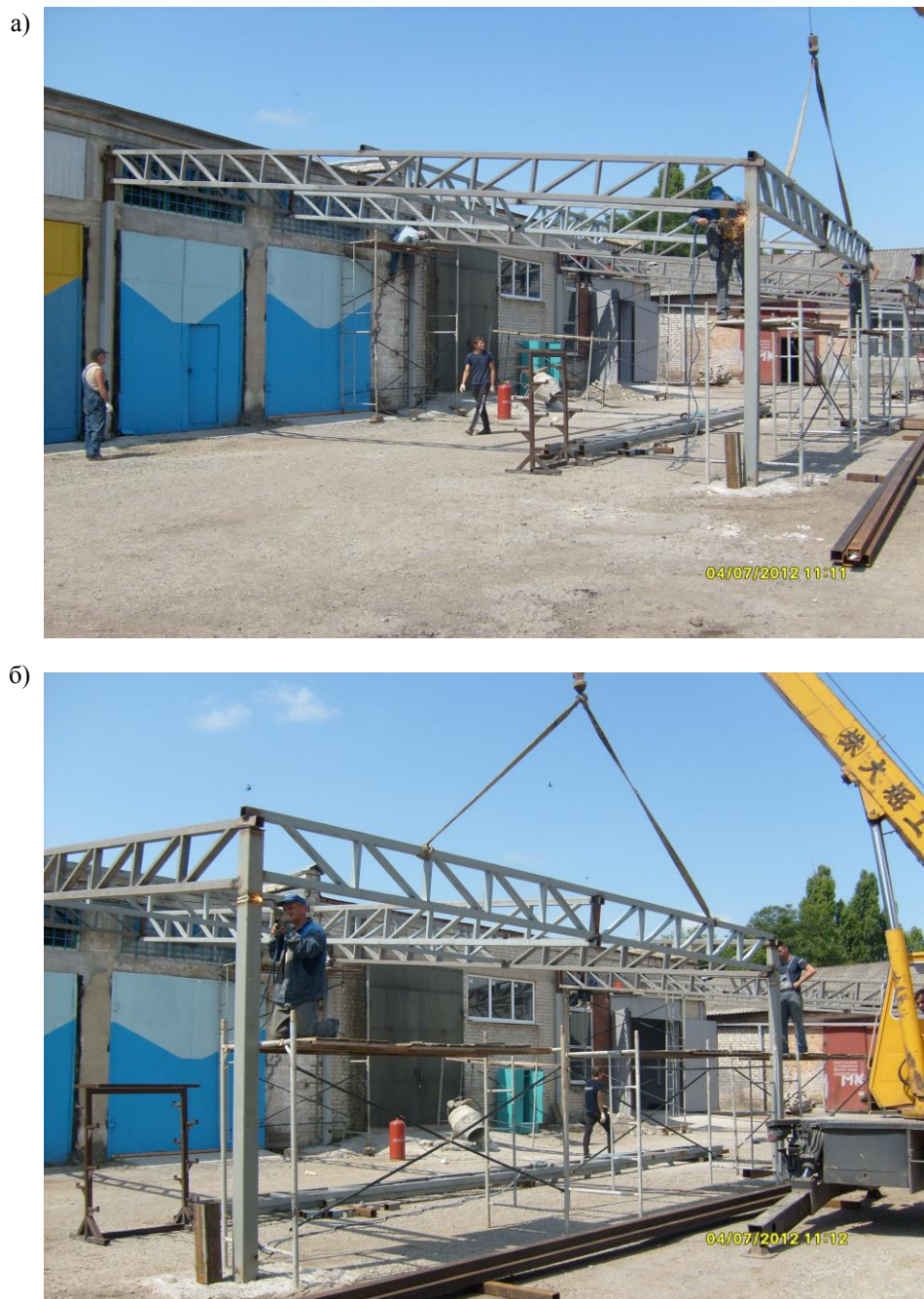
Рис. 7. Блоки покрытия из перекрестных стальных ферм типа «Пятигорск» при сетке колонн 12 \times 10 м в процессе монтажа: а – общий вид в направлении большего пролета; б – общий вид в направлении меньшего пролета
