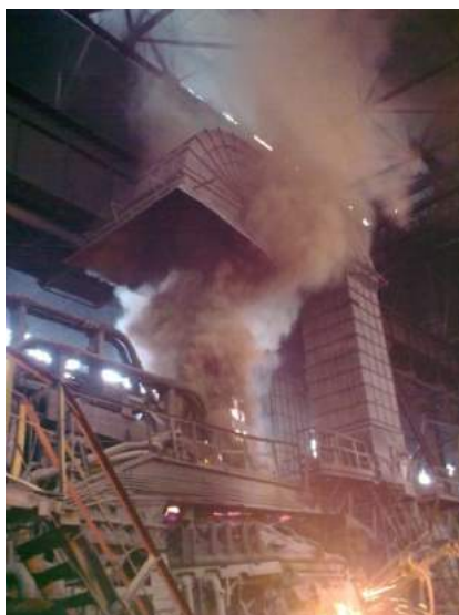
Рис. 3. Результаты неэффективной работы вытяжного зонта над печью ДСП-150
